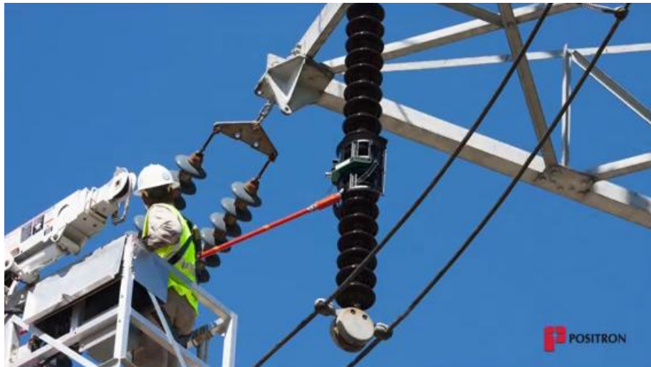
Figura 2: Operatori su una piattaforma durante un'ispezione di isolatore su linea elettrica in tensione.
