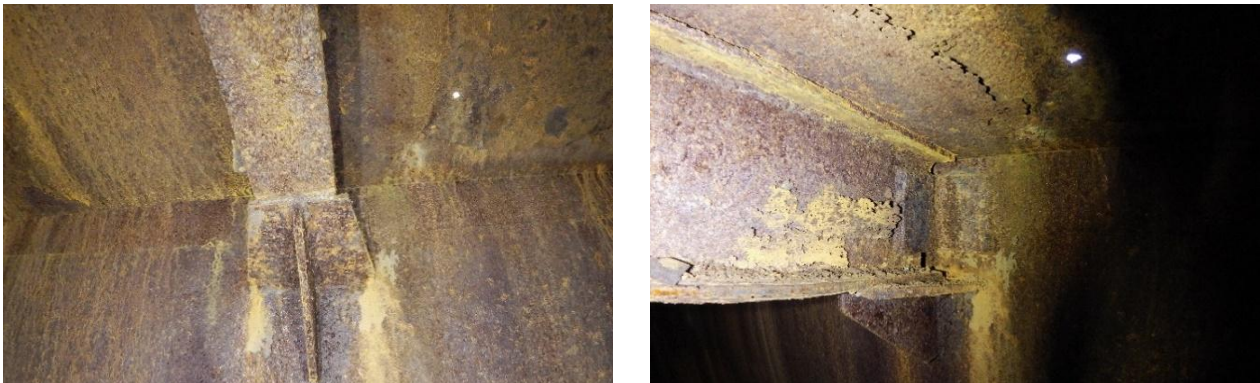
Fig.3 Dettagli dei punti di contatto tra le staffe di supporto delle travi e le virole del mantello di un serbatoio.
