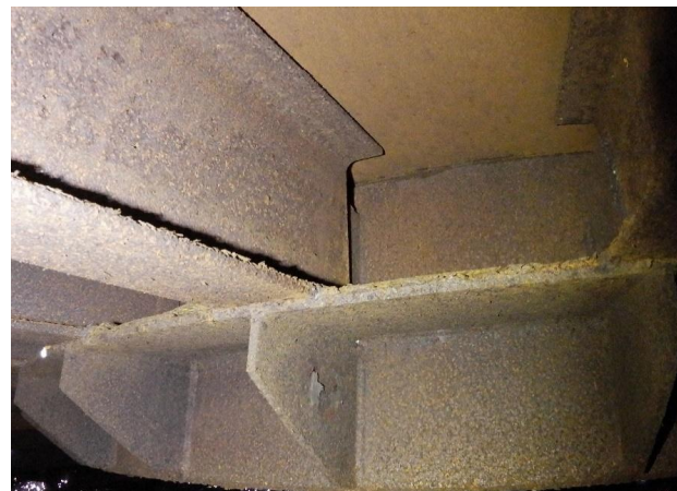
Fig. 2 Immagine della parte centrale del tetto di un serbatoio, acquisita con UAV munito di fotocamera.
