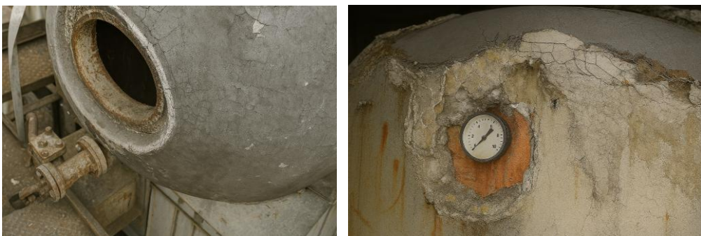
Figure 19 - tipologie di isolamenti per caldaie con materiale contenente amianto
