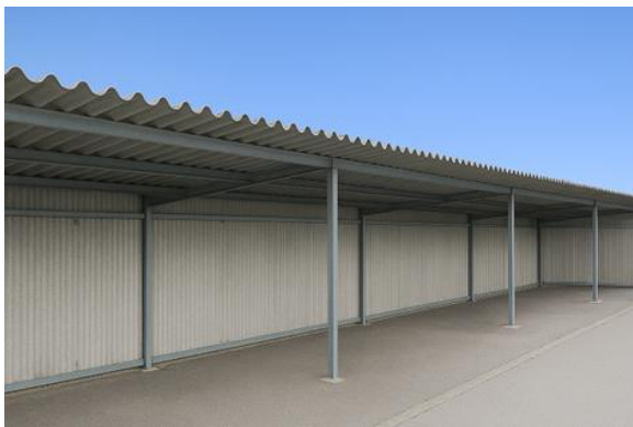
Figura 7 - pensilina in cemento-amianto
