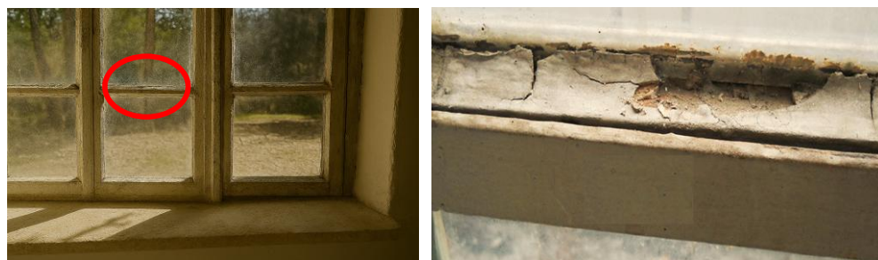
Figure 20 - finestra con mastice di contorno al vetro in materiale contenente amianto (sx) e particolare (dx)
