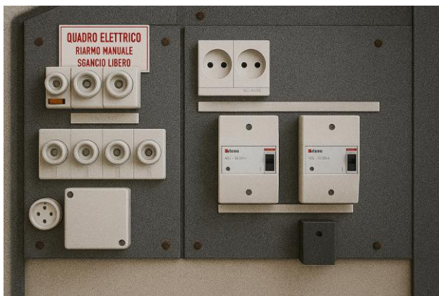
Figura 8 - quadro elettrico con lastre in cemento-amianto
