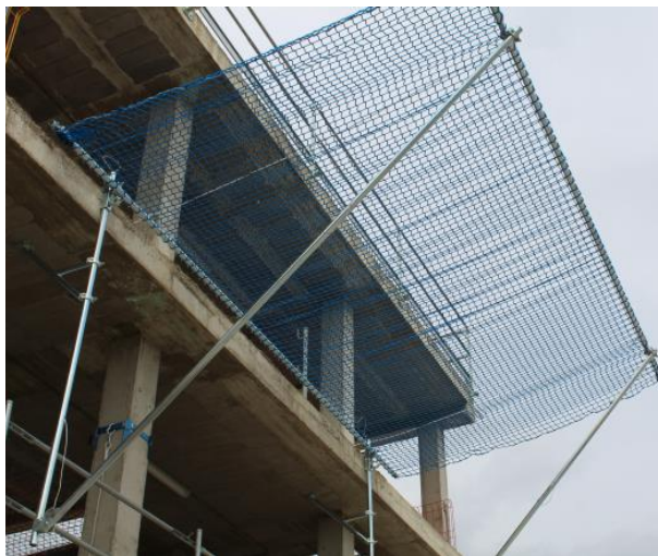
Figura 4.17-3 - Rete di sicurezza di tipo T (Reti Brembo)
