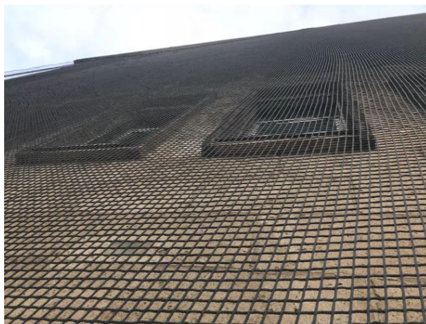
Figura 4.12-1 - Reti di protezione contro la caduta di oggetti (Leon De Oro)
