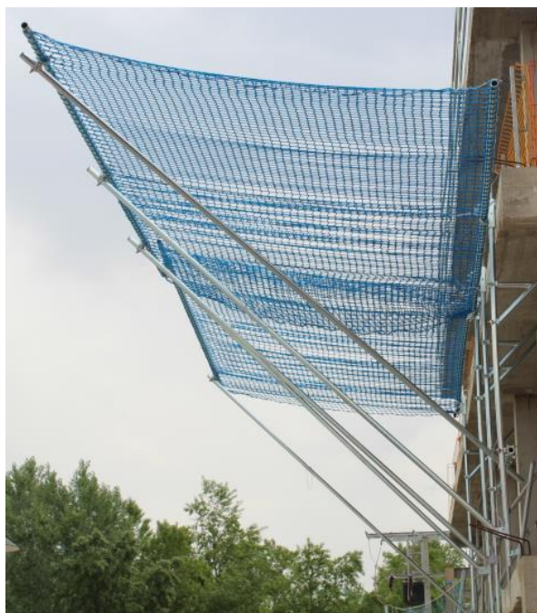
Figura 4.17-2 - Rete di sicurezza di tipo T (Reti Brembo)
