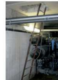
Figura 6 Ambiente assimilabile: locale tecnico piscine
